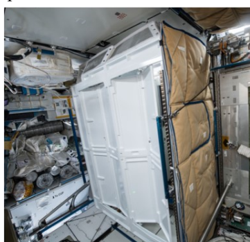
Cabine de toilettes double, comme les toilettes publiques sur Terre, installée sur la station spatiale. Cela abrite le compartiment d'hygiène des déchets existant, et UWMS.
